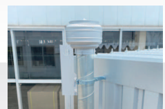
ベンチレーター（自然換気）
